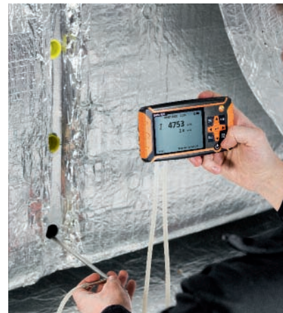
Измерение с помощью трубки Пито в воздуховоде
